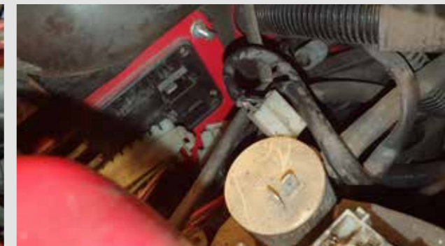
Kontakterna är loss och en av de fyra muttrarna som håller fast säkringsboxen syns.
